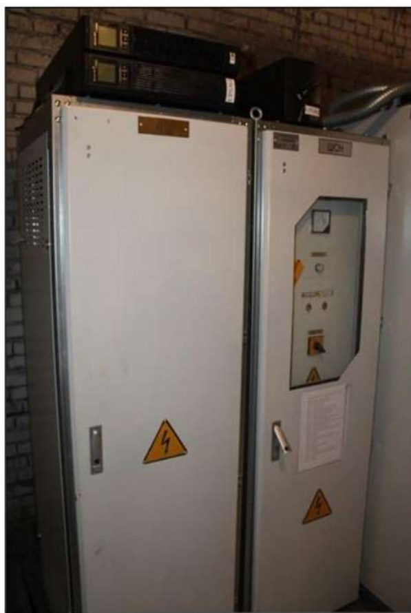
Шкаф собственных нужд 0,4кВ
